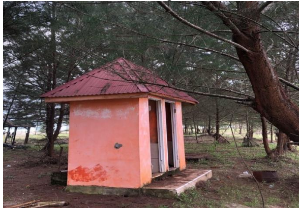
Gambar toilet yang sudah rusak di objek wisata bahari jembatan pelangi,2024
