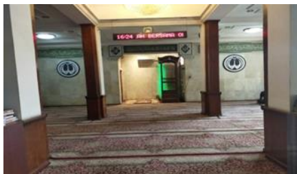
Gambar 2. Keempat tiyang kayu Saka Guru pada mesjid as salafiyah yang sudah direnovasi dan dilapisi oleh beton (Dokumentasi Pribadi)
