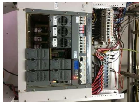
Gambar 4. Penghantar pada Bagian DC Distribution
