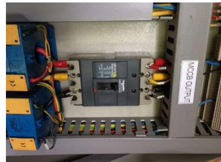
Gambar 3. Penghantar pada Bagian Panel Utama 3 Fase
