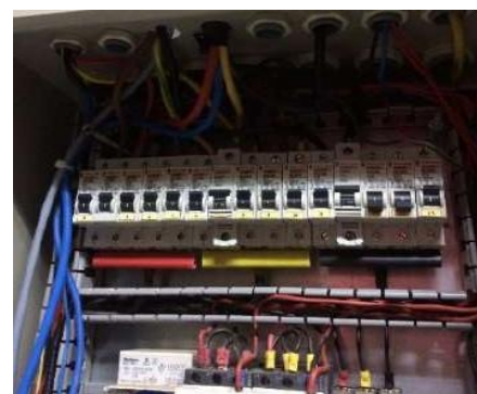
Gambar 2. MCB 1 phase pada ACPDB (Alternate Current Power Distribution Box)
