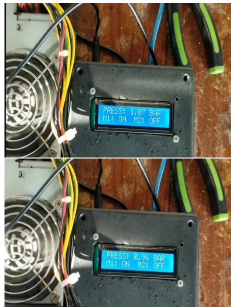
Gambar 9. Hasil Pembacaan Tekanan Pompa 1 dan Pompa 2
